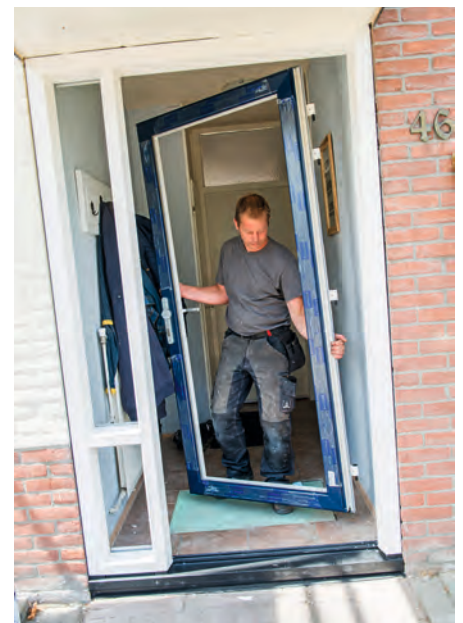
Het afhangen van het deurkader
